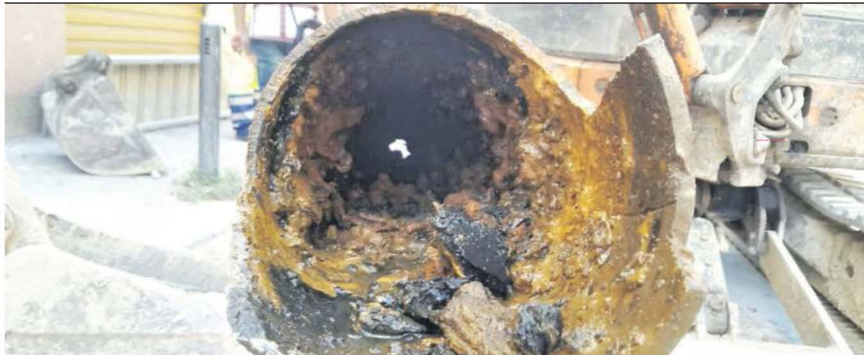
Una tubazione completamente corrosa: è il vero problema della rete idrica sarda
